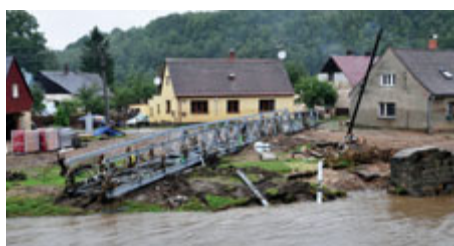
Zničený most přes řeku Nisu v Bílém Kostele po srpnové povodni v roce 2010. Foto: archiv LK.
